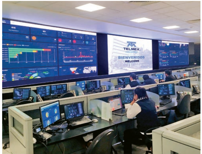
2021 - Última renovación de Centro de Monitoreo para Telmex
